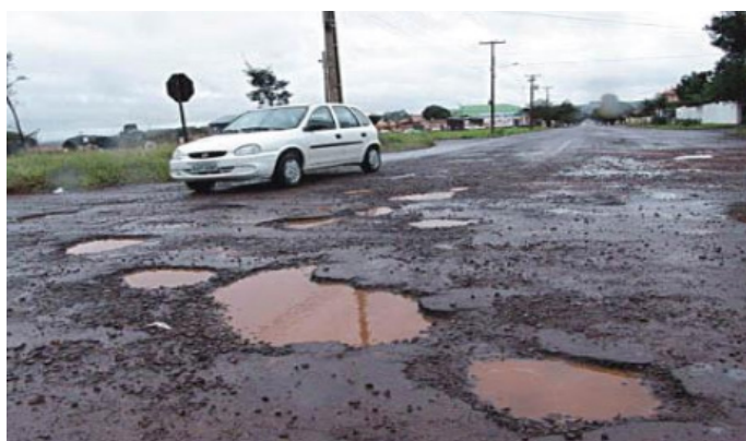
Figura 7 – Efeitos patológicos na pavimentação flexível Fonte: CNT (2017)
