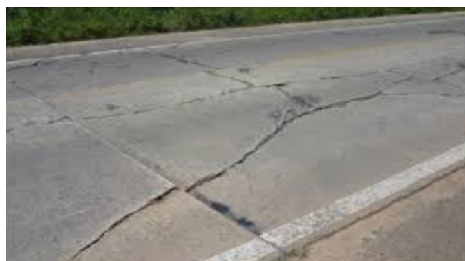
Figura 9 – Efeitos patológicos na pavimentação rígida Fonte: CNT (2017)
