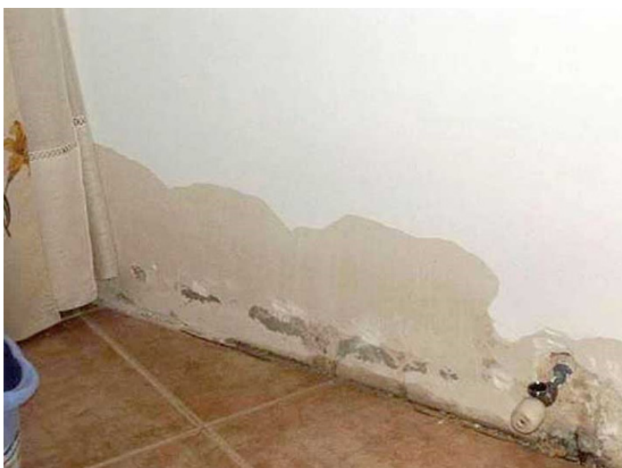
Figura 2 – Umidade na alvenaria Fonte: Fórum da Construção (2020)
