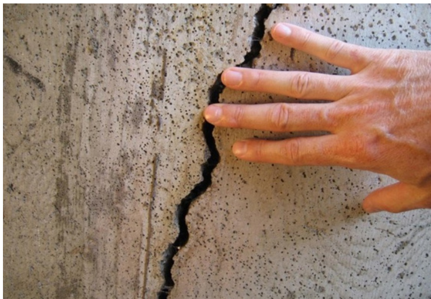
Figura 3 – Rachadura Fonte: Plantas de Casas (2020)
