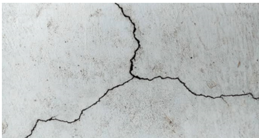
Figura 5 – Fissuras em alvenaria Fonte: Mão na Roda (2019)
