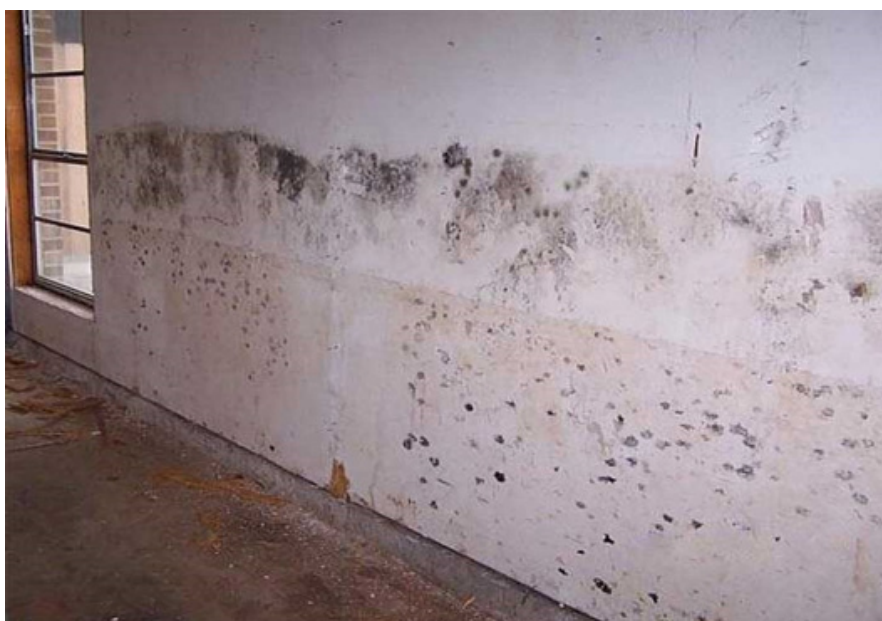
Figura 1 – Ocorrência de manchas características de umidade Fonte: Fórum da Construção (2020)
