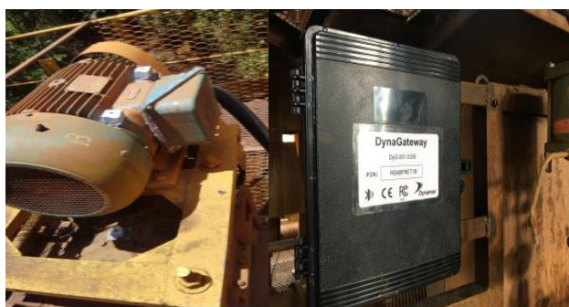
Figura 04 - Bombeamento do Prata e Monitoramento – Mina de Fábrica Fonte: VALE (2021).
