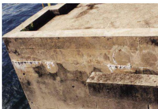
Figura 11 – Corrosão na estrutura interna do concreto Fonte: Rocha (2015)
