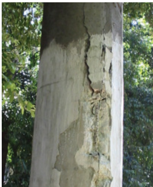
Figura 7. Corrosão química dentro da estrutura do concreto Fonte: Merçon; Guimarães; Mainier (2004)
