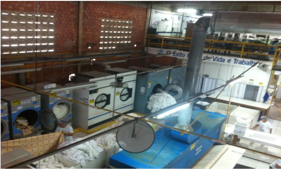
Figura 3 – Salão de Secar e Passar da Lavanderia em São Luís-MA
