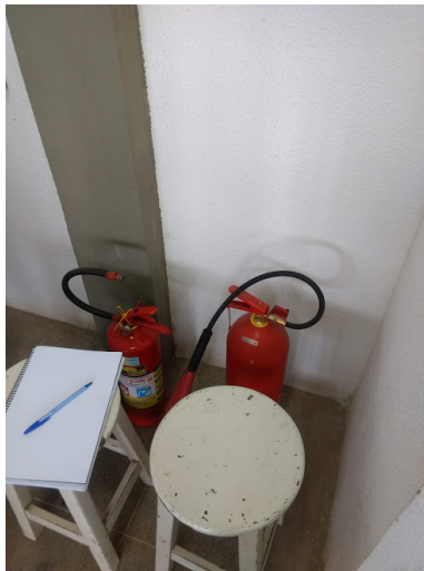
Figura 05 - Extintor de incêndio no chão e obstruído por cadeiras
