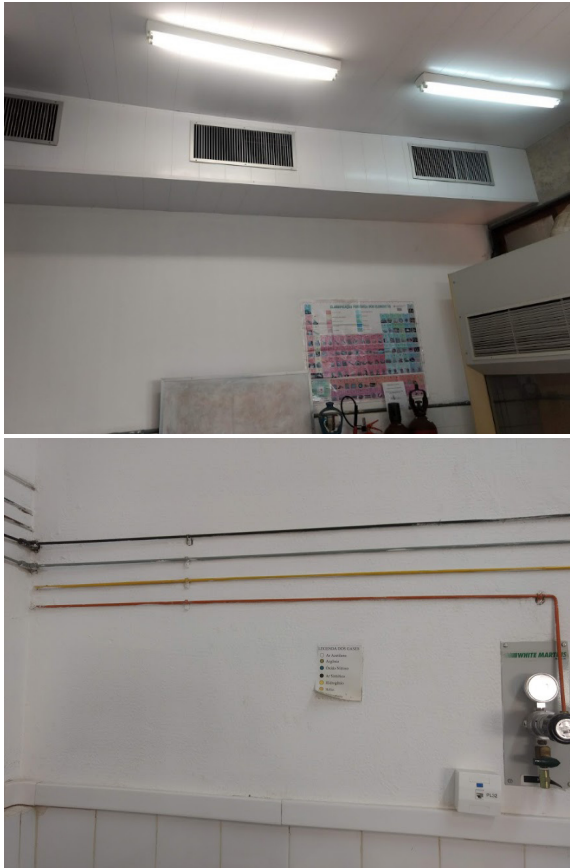
Figuras 11 e 12 - Duto de ventilação e linha de gases inoperantes Fonte: Autoria própria (2019)
