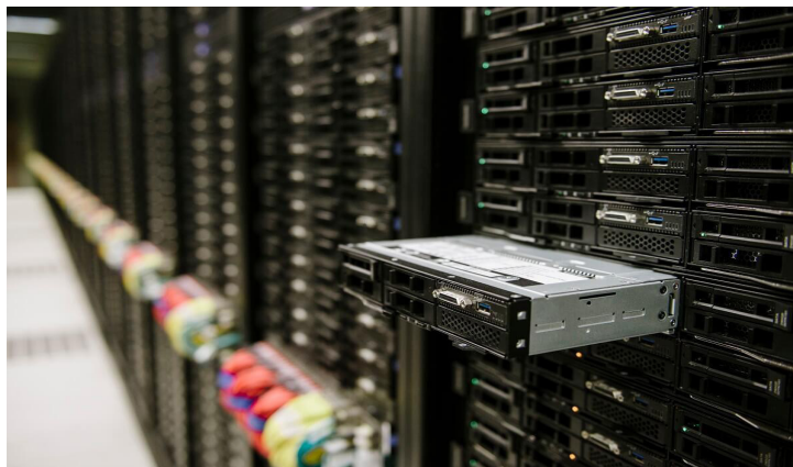
Figura 2: Um Equipamento de TI sendo colocado no raque
