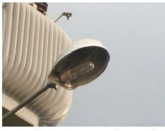
FIGURA 31. Luminária Inadequada para utilização em iluminação pública.
