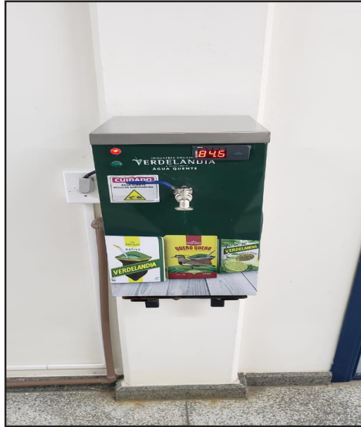
Figura 7. Máquina para o aquecimento da água.
