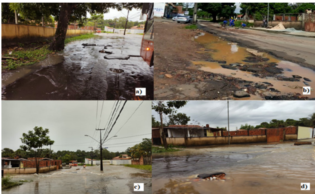
Figura 07: a) Problemas no pavimento e alagamento dificultando tráfego de veículos. b) Defeitos de pavimento provocados pelo escoamento superficial. c) Problemas de alagamentos no local de estudo. d) Alagamentos com arraste de resíduos sólidos na via. Fonte: Autora (2020).
