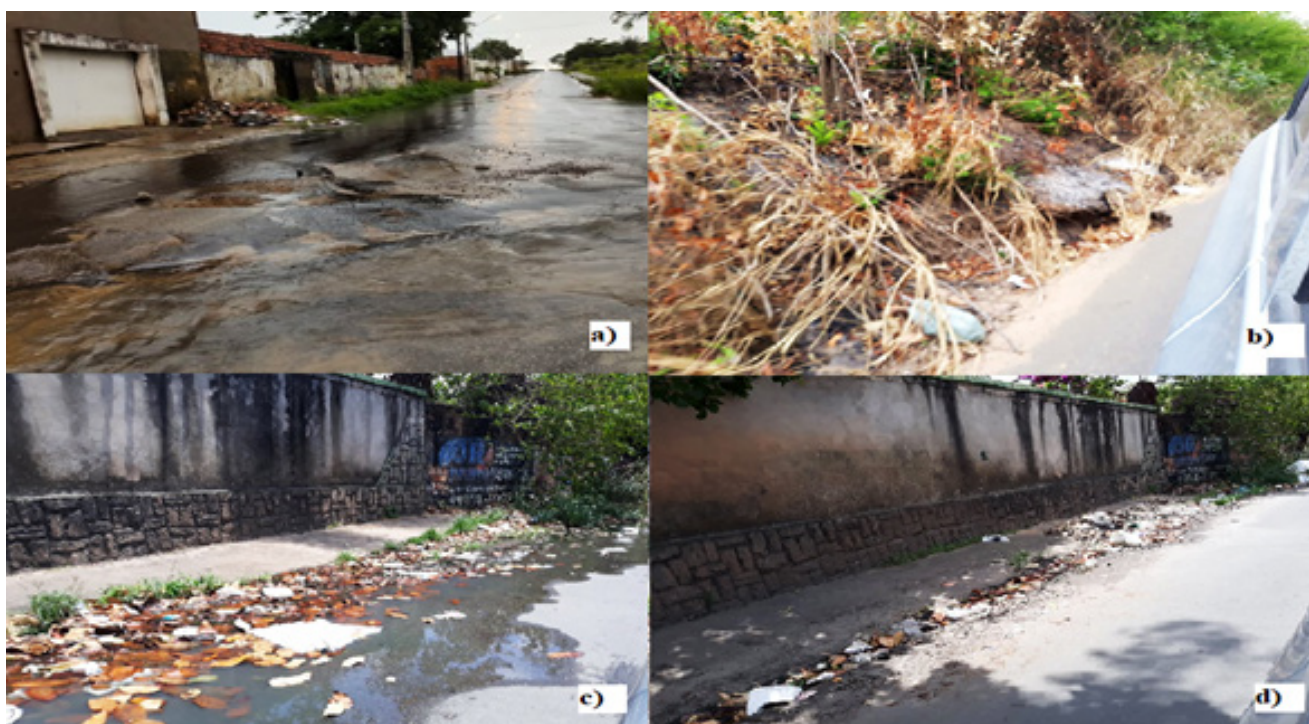
Figura 06: a) Defeitos no pavimento da Rua Xavier Chaga. b) Processos erosivos na extremidade da estrada. c) Resíduos sólidos associados a descarga irregular de esgoto sanitário residencial. d) Resíduos sólidos no limite da pista.
