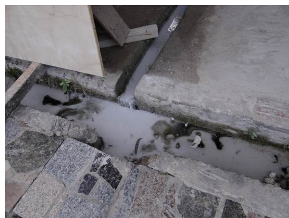
Figura 6 – Escoamento da água sem grade
