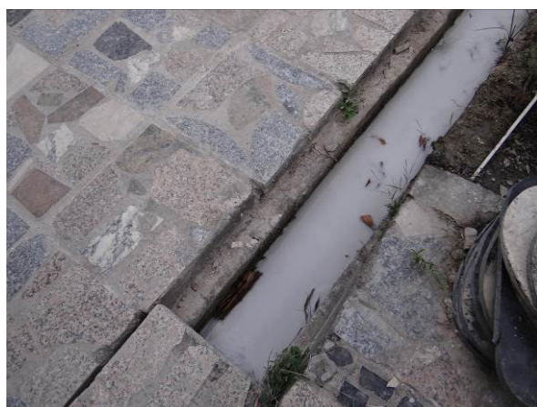
Figura 5 – Escoamento da água sem grade
