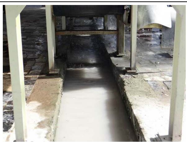
Figura 4 – Escoamento da água sem grade
