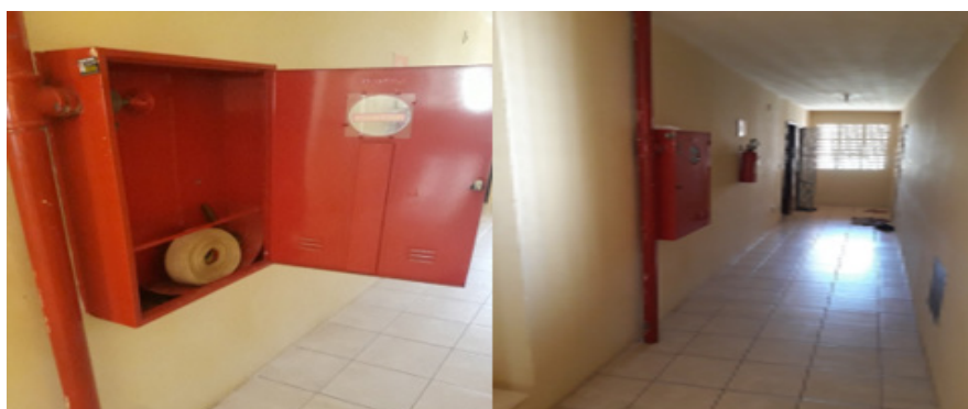
Figura 7 - Caixa de hidrante do pavimento Fonte: do autor
