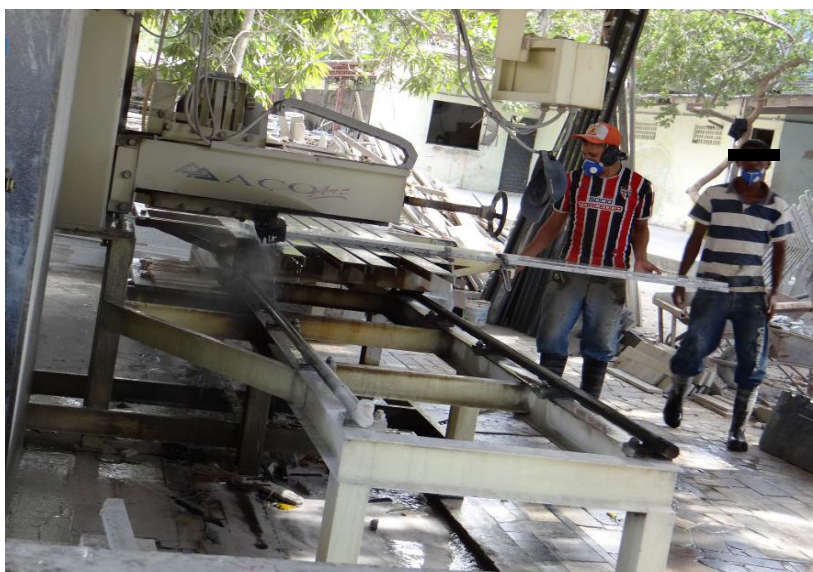
Figura 12 – Funcionários sem EPI de proteção contra umidade
