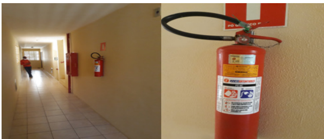
Figura 6 - Unidade extintora localizado no pavimento Fonte: do autor
