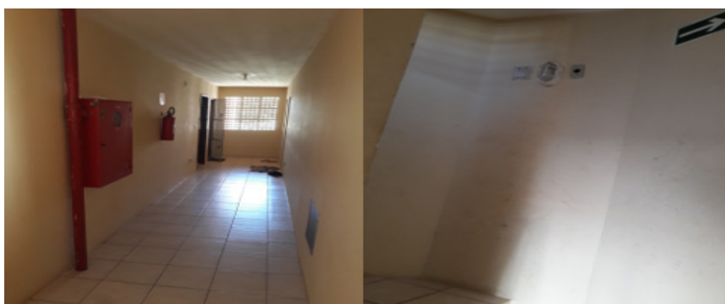
Figura 4 - Ausência de Luminárias de Emergência no pavimento Fonte: do autor
