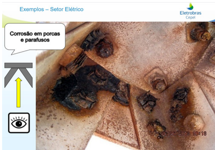
Figura 1 – Corrosão de componentes metálicos em juntas parafusadas Fonte: Eletrobras, 2012.
