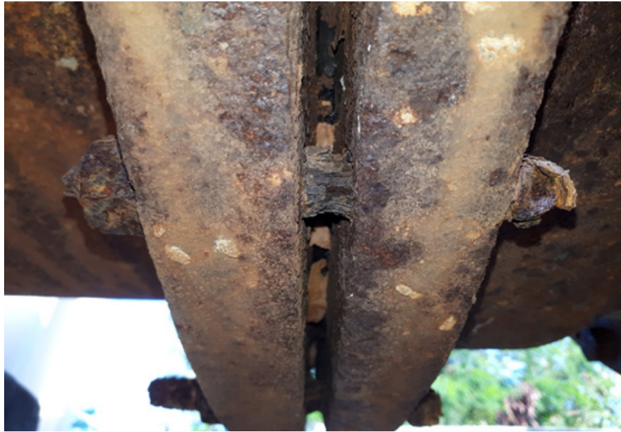
Figura 4 - Parafusos de aço em estado avançado de degradação Fonte: O próprio, 2020.
