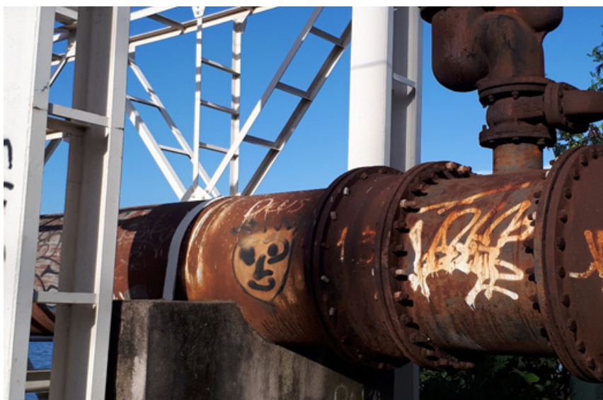
Figura 3 – Corrosão estrutural na costa marítima.
