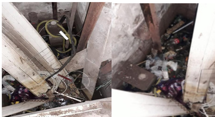
Figura 5 – Poço de elevador não funcional como ponto de descarte do lixo Fonte: Arquivo pessoal
