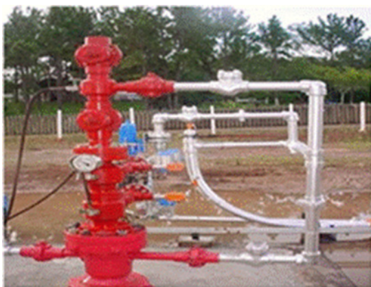
Figura 2 - Poço produtor de petróleo e gás Fonte: Foto do autor, 2020
