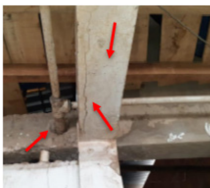
Figura 11 - Viga apresentando trinca e fissura Fonte: Arquivo pessoal
