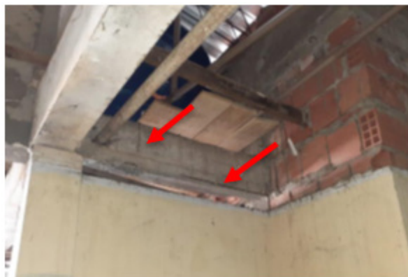
Figura 12 - Viga contendo armaduras expostas Fonte: Arquivo pessoal
