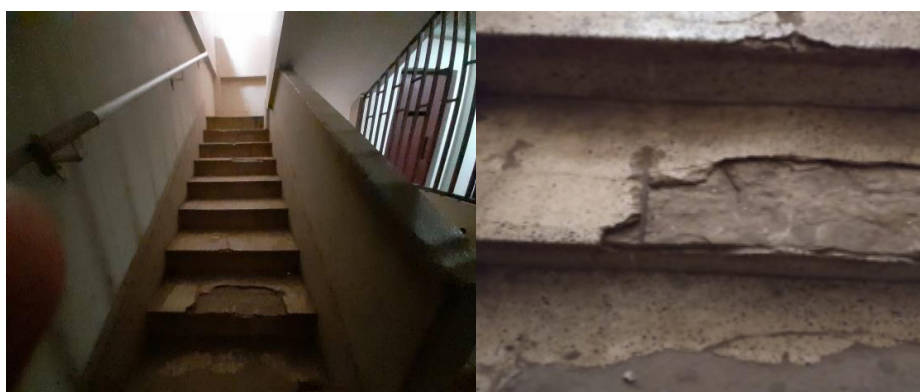
Figura 6 - Perda de seção do degrau da escada de acesso ao 2º pavimento Fonte: Arquivo pessoal
