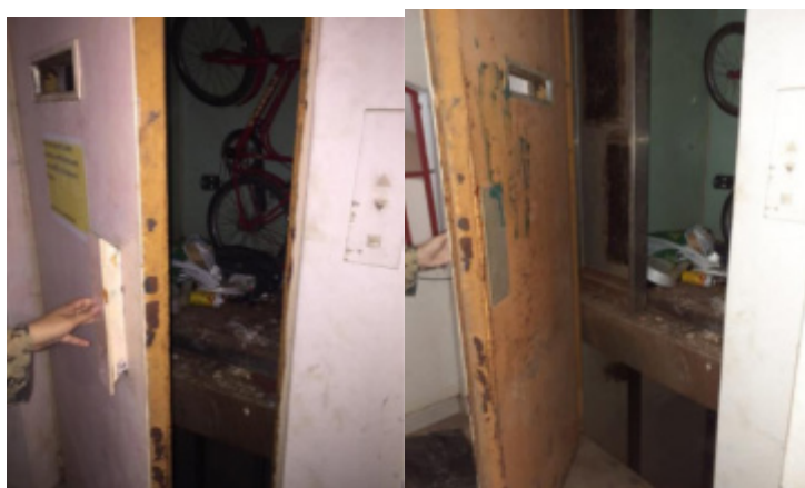
Figura 9 - Porta do elevador não funcional de fácil abertura Fonte: Arquivo pessoal
