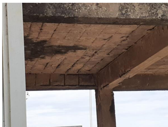
Figura 13 - Armaduras expostas em estrutura do reservatório Fonte: Arquivo pessoal
