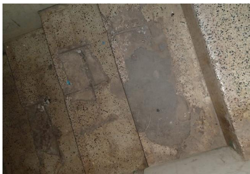
Figura 7 – Preenchimento improvisado da seção do degrau Fonte: Arquivo pessoal
