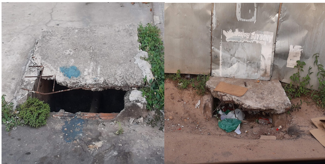
Figura 5- Boca de lobo de guia 03 e boca de lobo de guia 04 Fonte: Acervo do autor, (2020)
