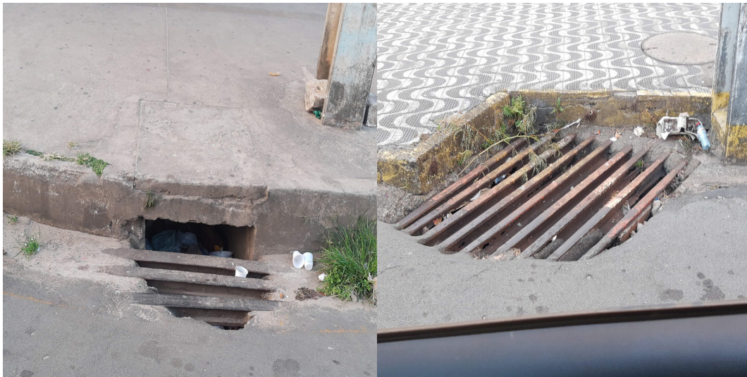
Figura 8- Boca de lobo combinada 09 e boca de lobo com grelha 10 Fonte: Acervo do autor, (2020)
