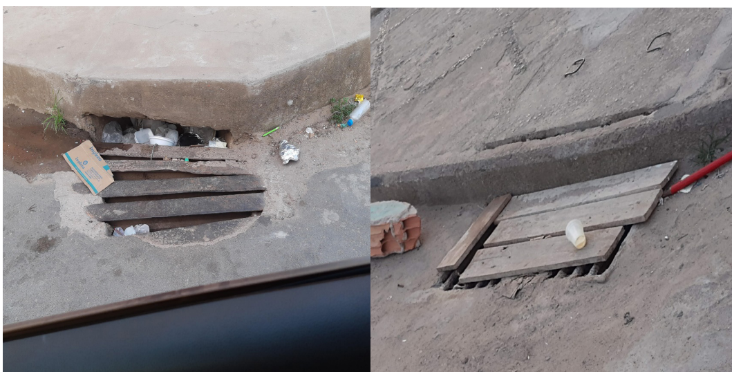
Figura 7- Boca de lobo combinada 07 e boca de lobo com grelha 08 Fonte: Acervo do autor, (2020)
