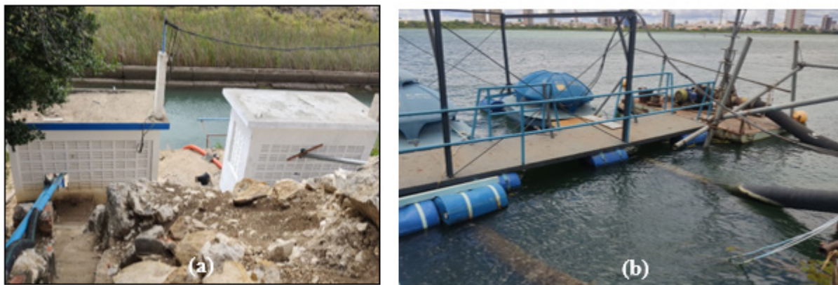
FIGURA 1. Localização das casas de bombas das ETA's Carnaíba e Juremal (a) e captação no Rio São Francisco Juazeiro (b).
