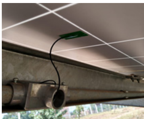
Figura 11 – Detalhe do sensor termopar fixado na superfície traseira do painel fotovoltaico
