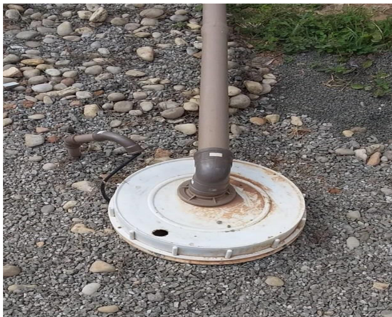
Figura 7 – Reservatório para coleta de água de perda Fonte: Acervo do Autor, (2020)
