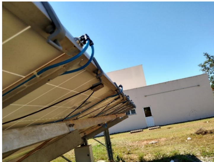
Figura 8 – Detalhes da tubulação com mangueiras de poliuretano
