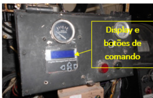
Figura 2 - Painel de controle do sistema de ignição.
