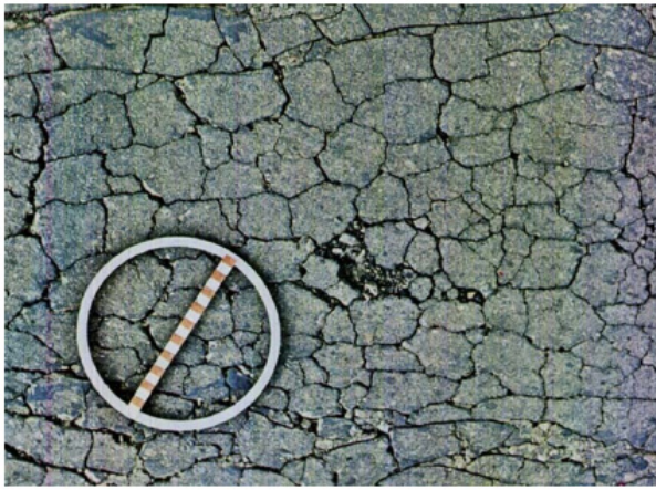
Figura 9: Trinca "couro de jacaré" Fonte: DNIT (2003a)
