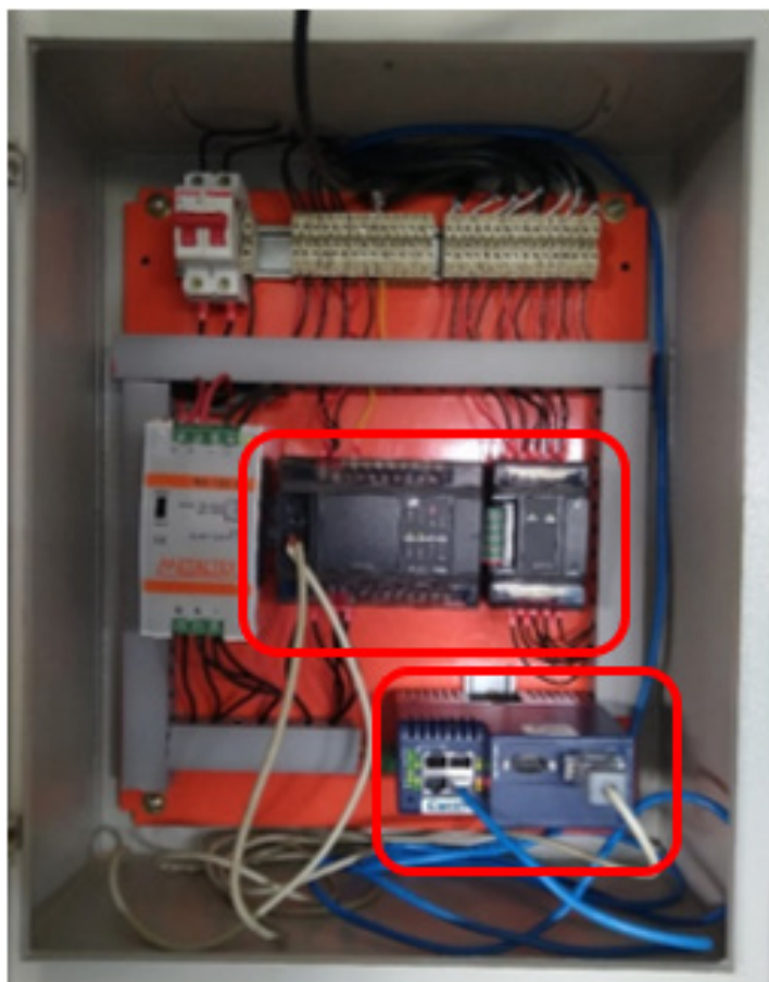
Figura 12 – Vista interna do quadro com dispositivos (fonte de tensão, CLP e Flexy)
