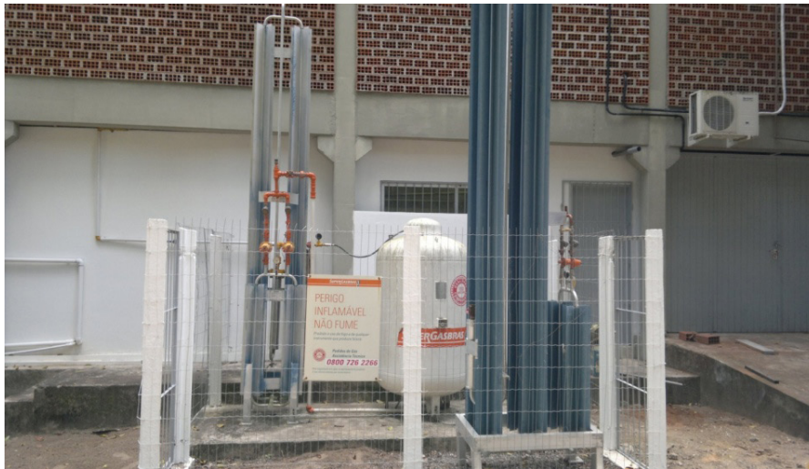
Figura 4 - Central de gás LP de 500 kg com vaporizador atmosférico. Fonte: O Autor
