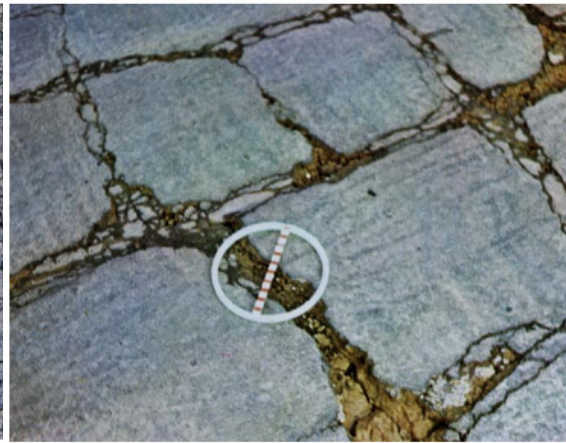
Figura 10: Trinca do tipo bloco Fonte: DNIT (2003a)
