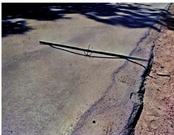
Figura 3: Afundamento Fonte: DNIT (2003a)
