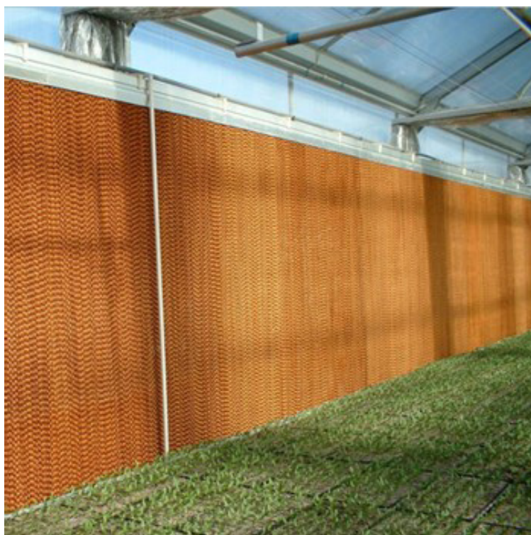
Figura 2 - Estufa Climatizada. Fonte: Os Autores.
