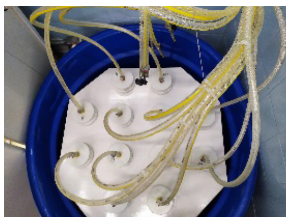
Figura 6 – Sistema de armazenagem do biogás (gasômetros) Fonte: Autores (2021)
