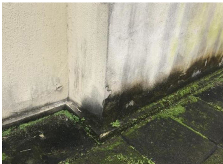
Figura 6. Infiltração por Capilaridade
