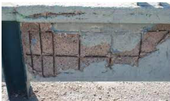
Figura 2. Umidade nas armaduras
