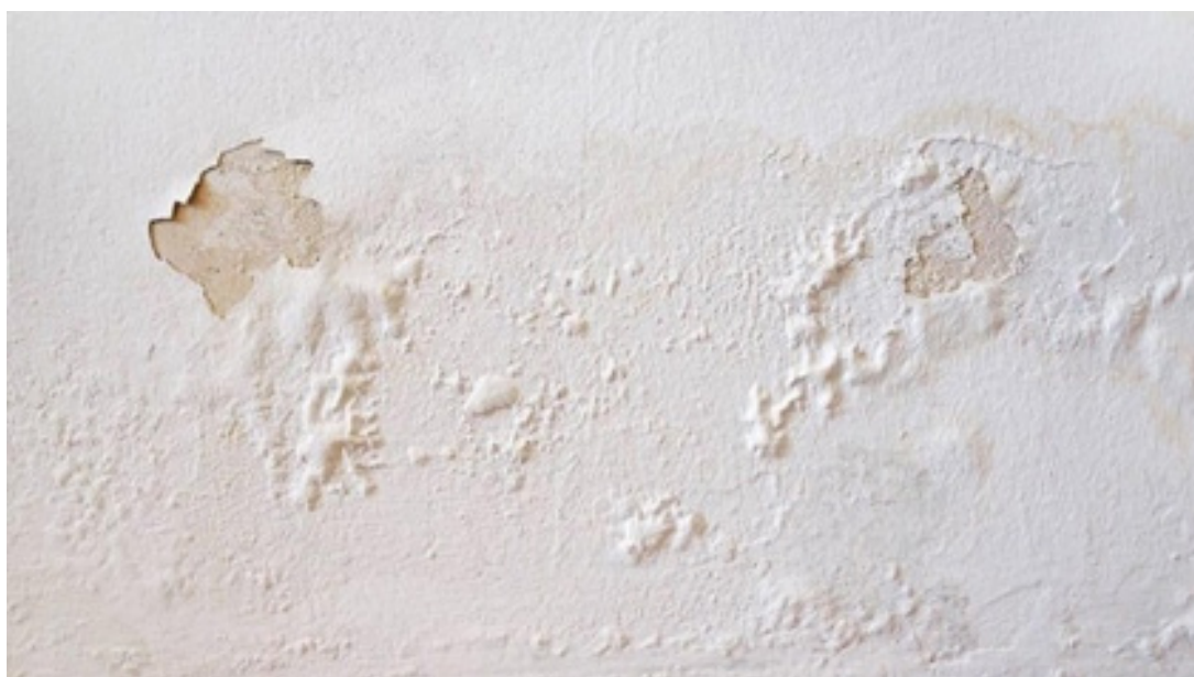
Figura 4 - Bolors na parede.
