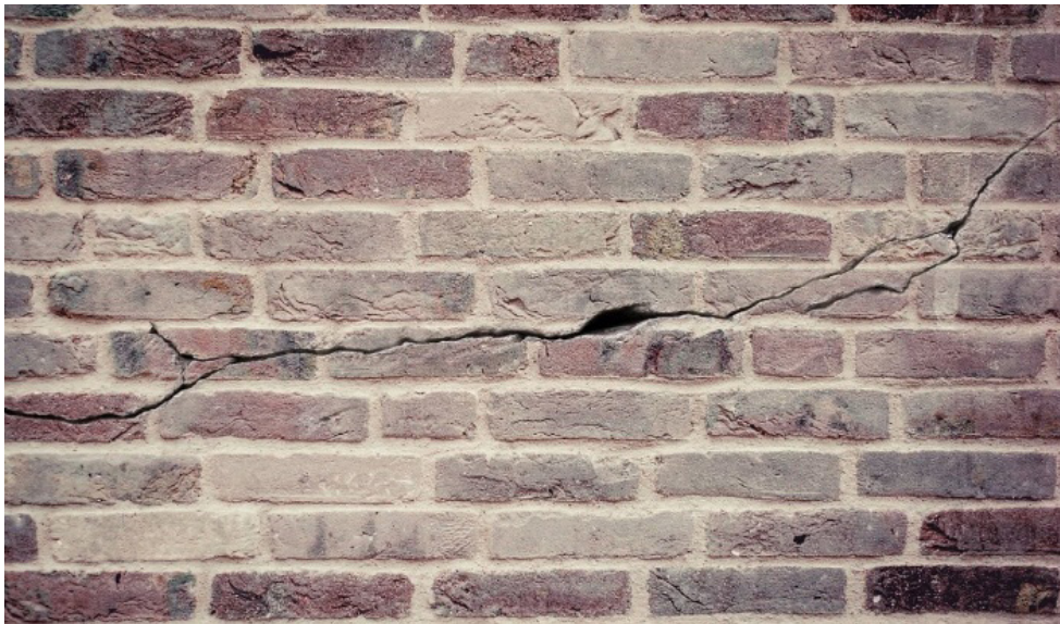
Figura 1 – Rachadura em estágio inicial em parede
