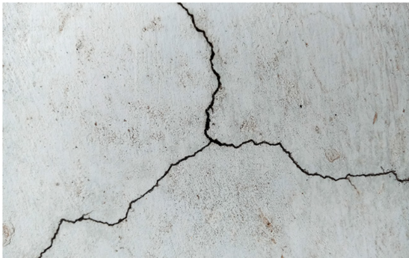
Figura 2 – Fissura de espessura 0,5mm
