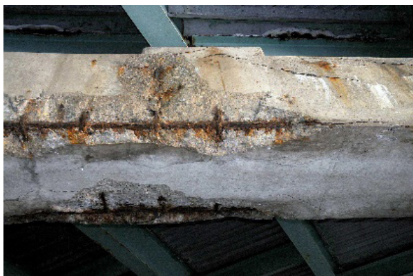
Figura 1. Umidade nas armaduras
