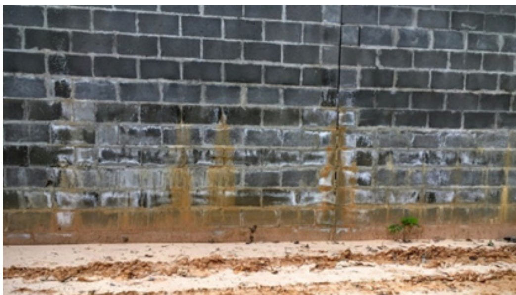
Figura 1 – Eflorescência em bloco de concreto.
