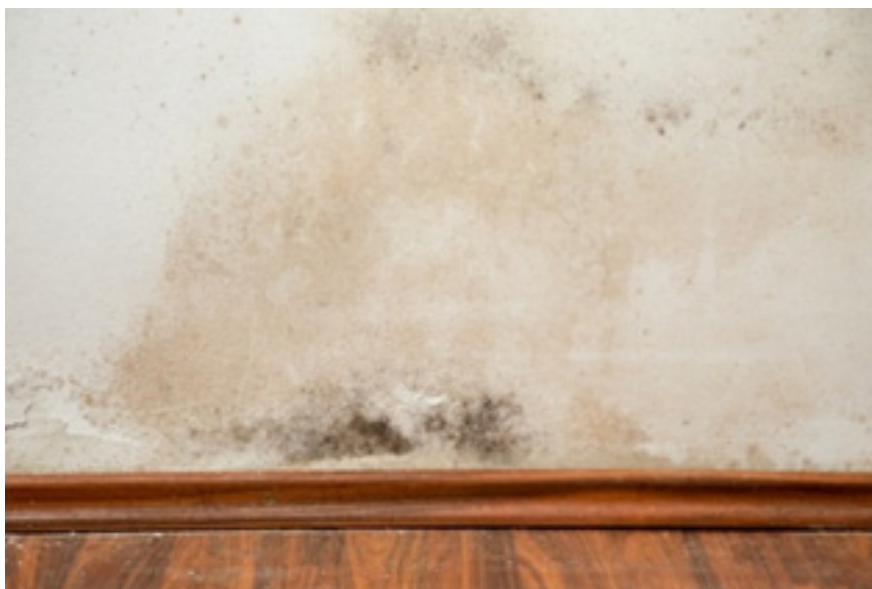
Figura 3 – Mofo na parede.
