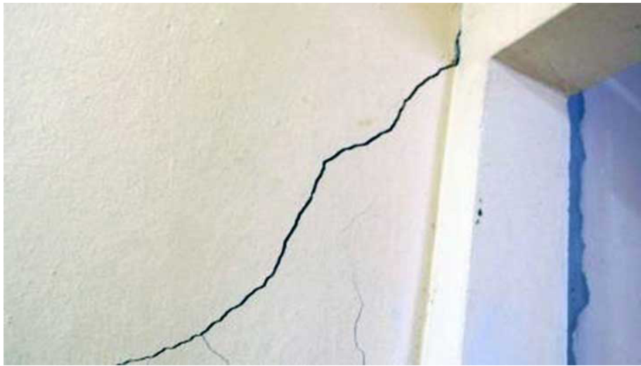
Figura 3 - Trinca em parede residencial
