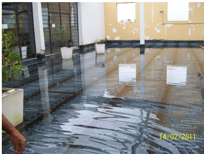
Figura 5. Teste de estanqueidade
