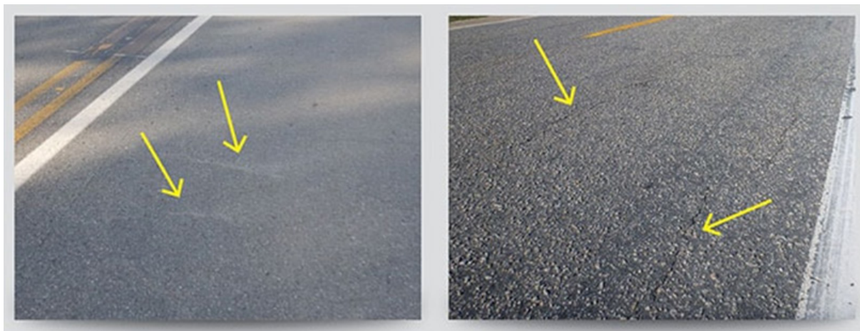
Figura 2. Fissuras no pavimento flexível Fonte: SindEtrans (2018)
