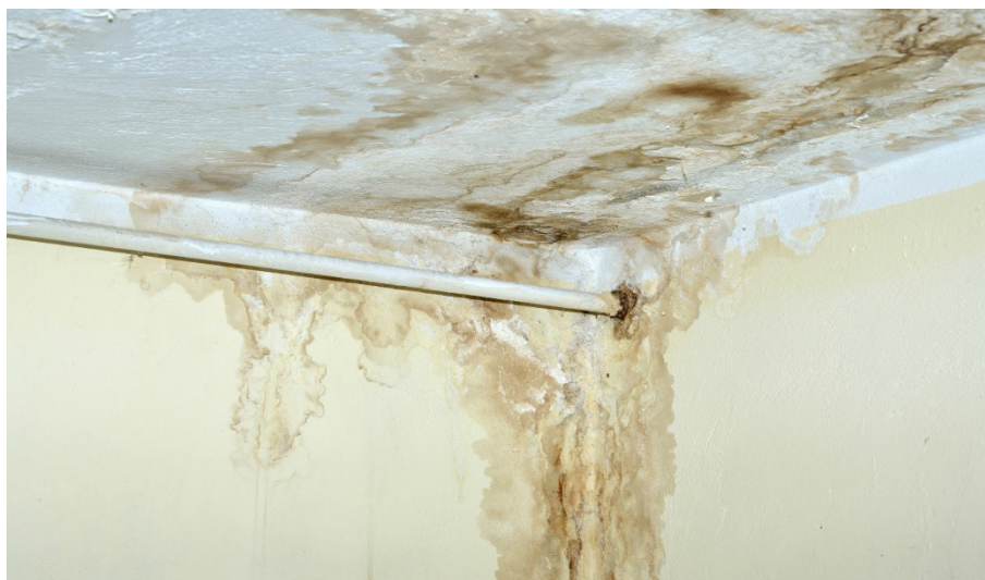
Figura 1. Bolhas na pintura e manchas pretas e acinzentadas na superfície do Teto e paredes.
