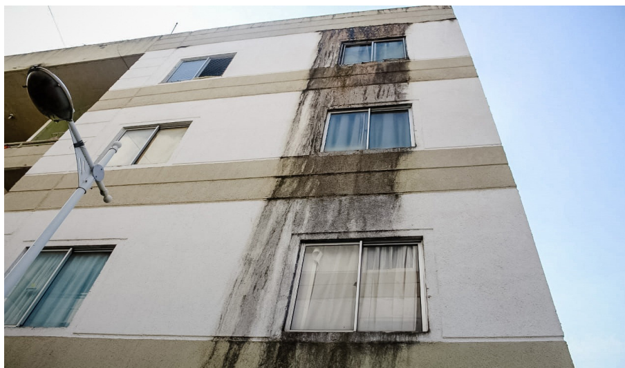
Figura 2. Infiltração e mofo na área exterior do prédio residencial
