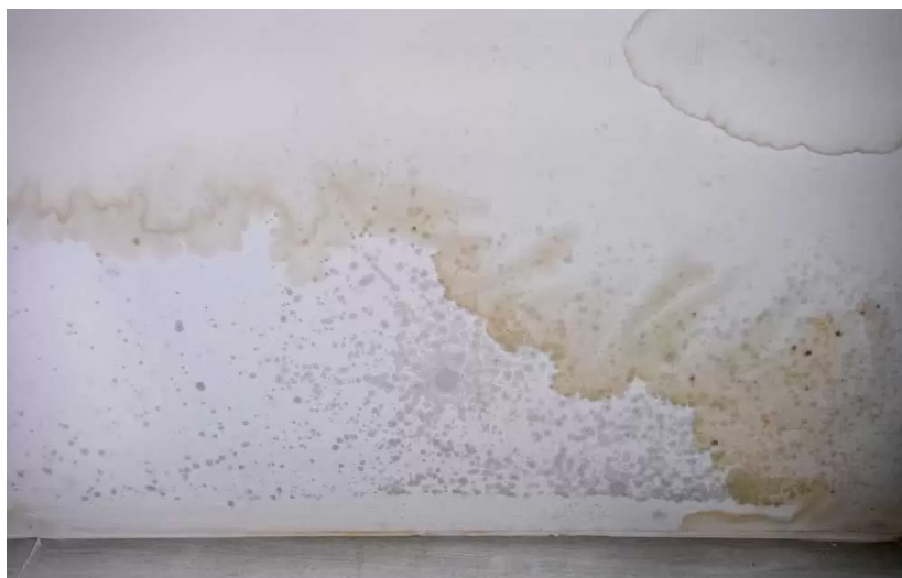
Figura 1. Infiltração em residência
