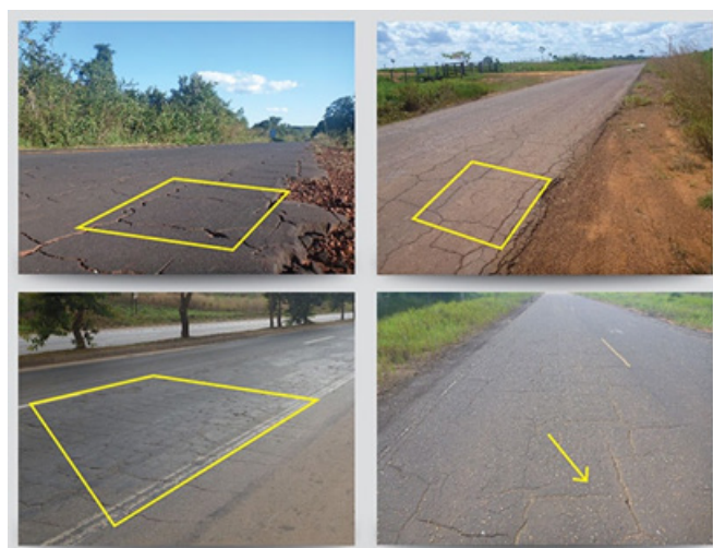
Figura 6. Trinca interligada tipo “bloco” Fonte: SindEtrans (2018)
