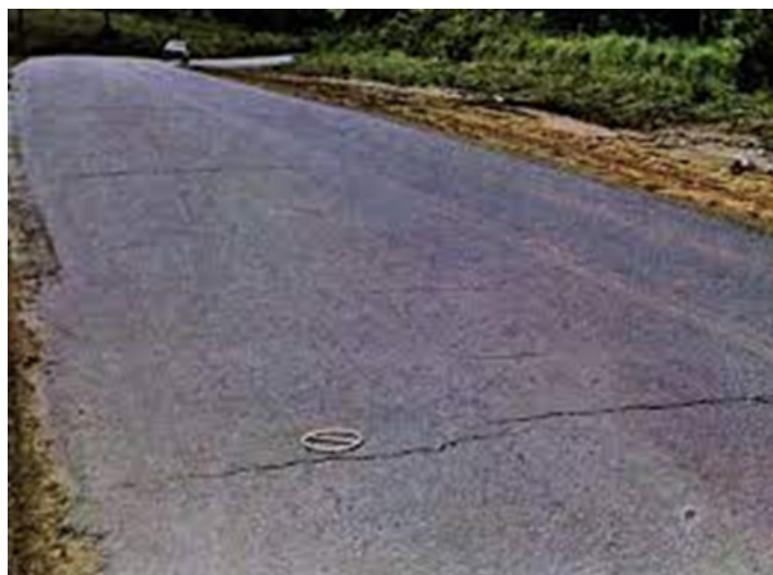
Figura 3. Trinca isolada transversal Fonte: DNIT (005/2003)
