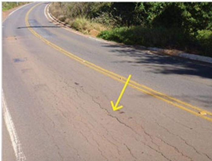
Figura 4. Trinca isolada longitudinal Fonte: SindEtrans (2018)
