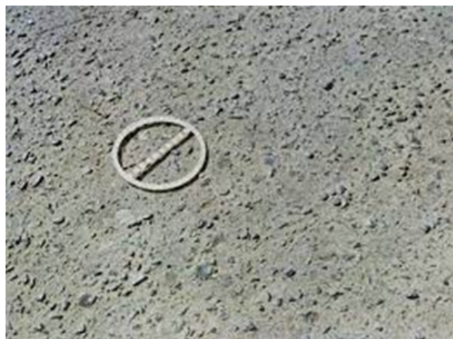
Figura 11. Desgaste do pavimento flexível Fonte: DNIT (005/2003)
