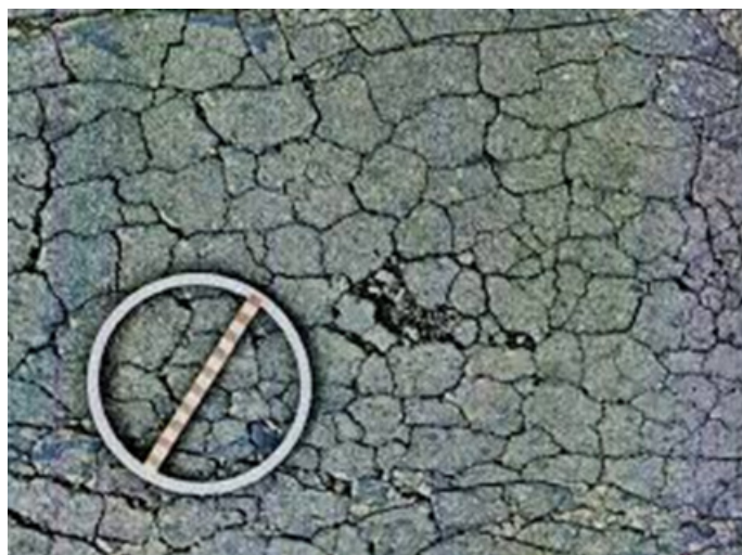
Figura 5. Trinca interligada tipo “couro de jacaré” Fonte: DNIT (005/2003)
