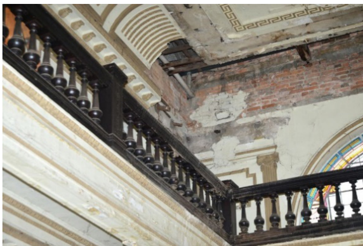
Figura1. Exemplo de edifício histórico com cobertura danificada.
