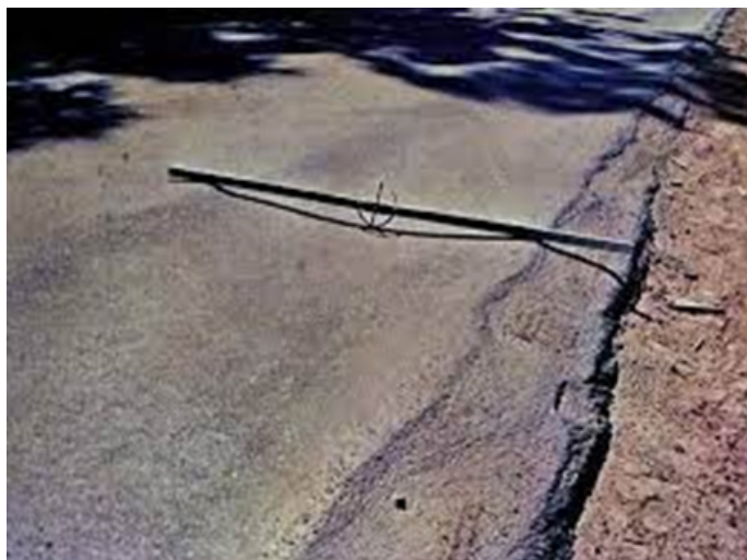
Figura 12. Afundamento de trilha de roda no pavimento flexível Fonte: DNIT (005/2003)
