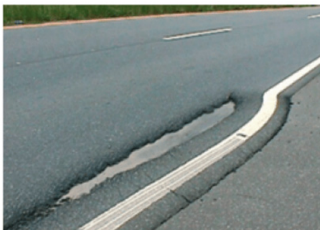
Figura 8. Escorregamento do pavimento flexível Fonte: Inova Civil (2019)
