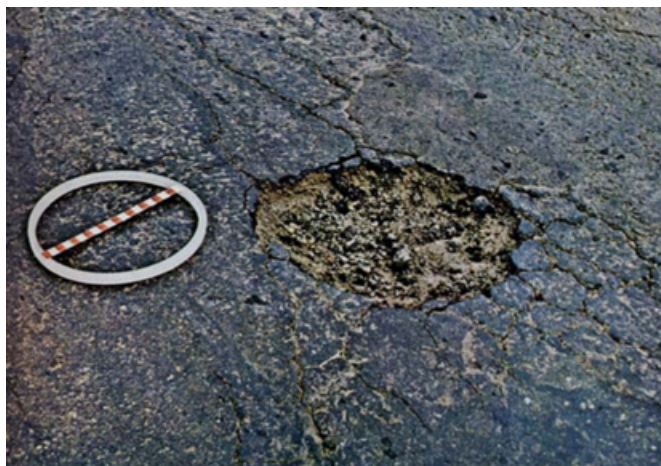
Figura 10. Panela ou Buraco no pavimento flexível Fonte: DNIT (005/2003)
