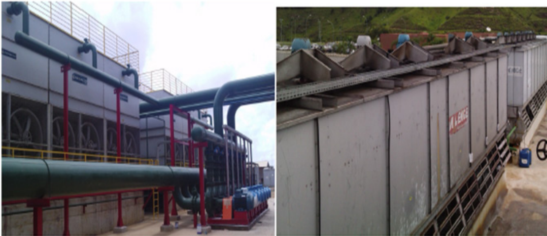
Figura 5. Torres de resfriamento e condensadores evaporativos com ventiladores axiais
