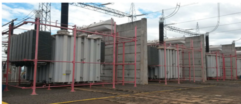
Figura 3. Banco de transformadores de potência 525/230kV
