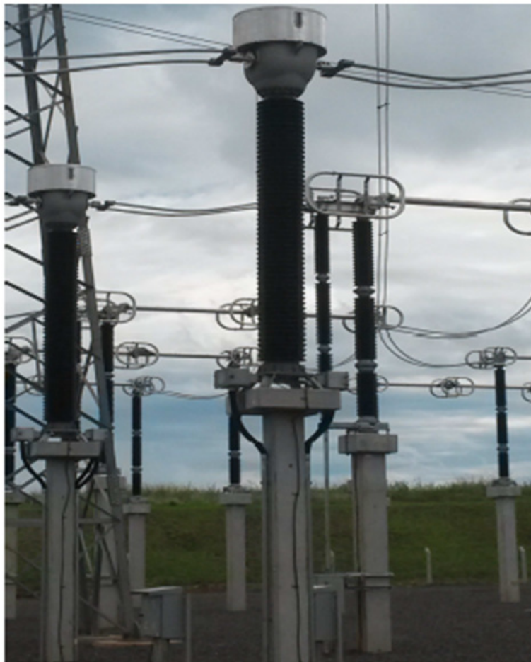
Figura 4. Transformador de corrente 525kV.
