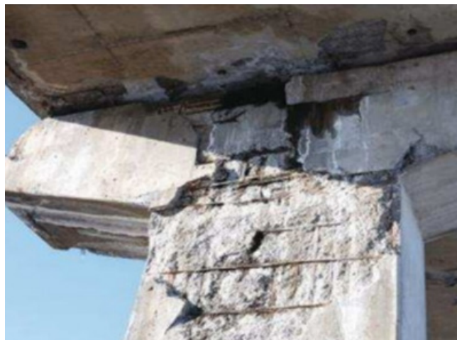
Figura 3. Deterioração da estrutura de concreto armado
