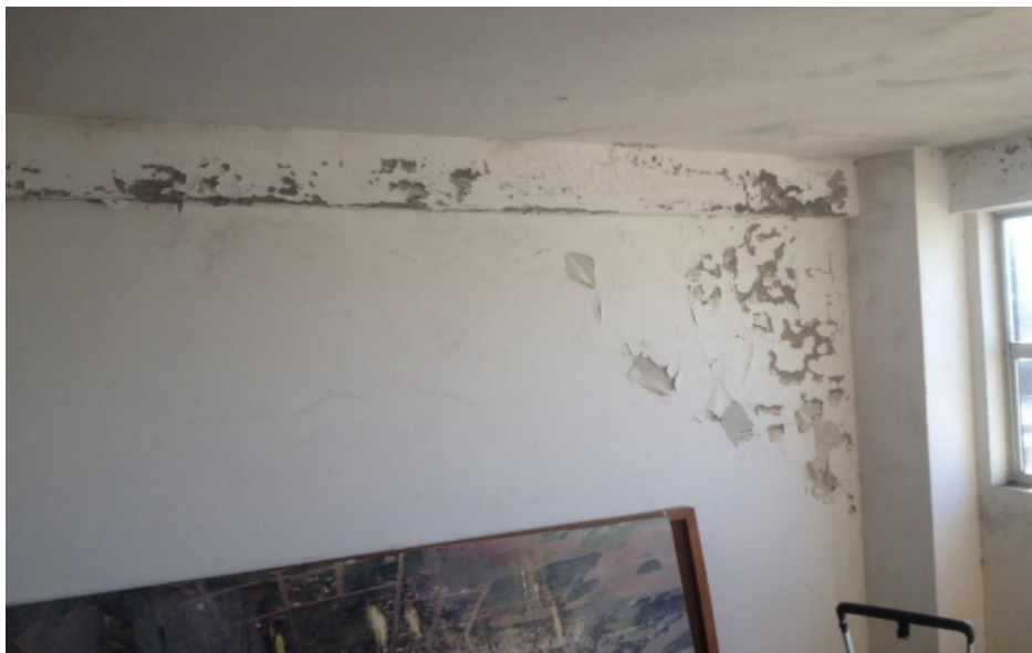
Figura 3. Patologia devido a umidade e infiltrações
