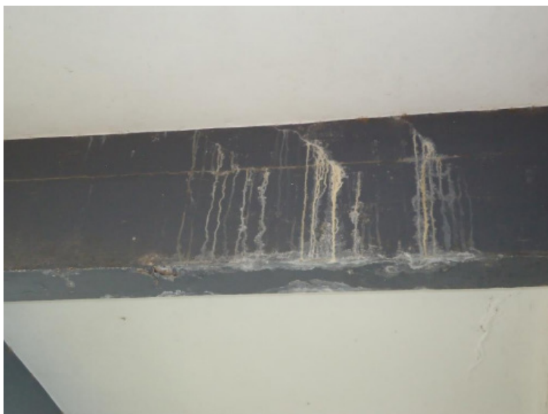
Figura 4. Eflorescências em uma edificação
