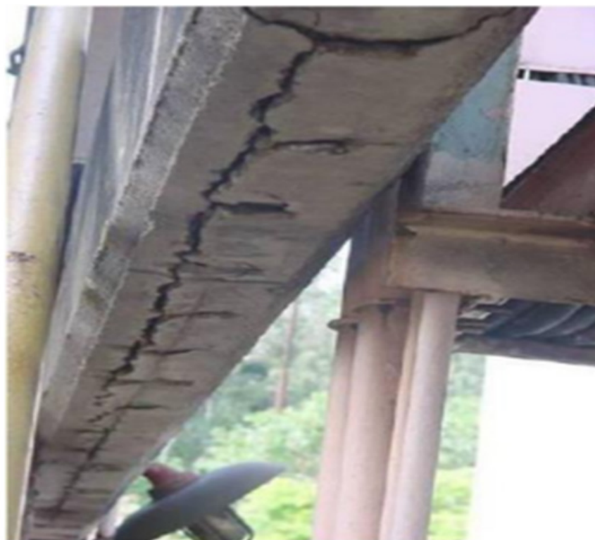
Figura 5. Fissura em viga causada pela expansão dos óxidos
