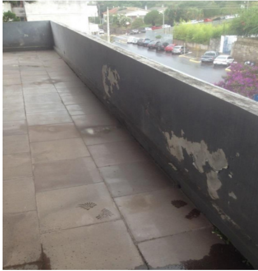
Figura 5. Eflorescências em uma edificação comercial
