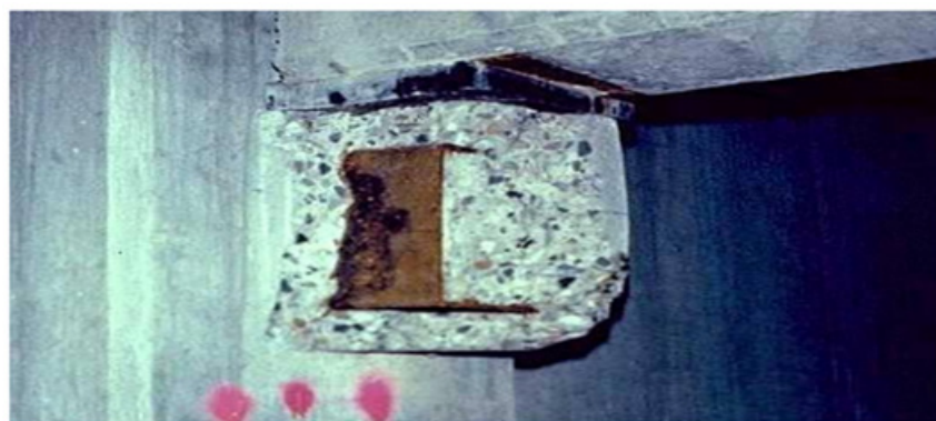
Figura 4. Fissuras em concreto.
