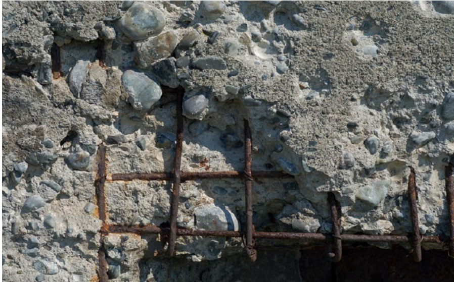
Figura 1. Exemplo de corrosão em estruturas de concreto
