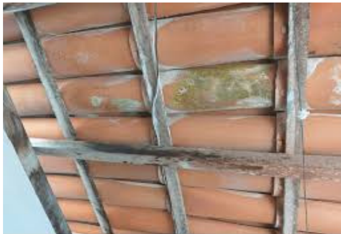
Figura 2. Infiltração nos telhados
