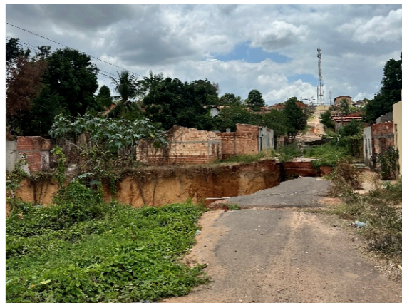
Figura 2: voçoroca em via pública
