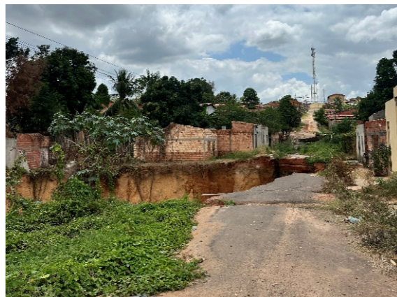
Figura 2: voçoroca em via pública
